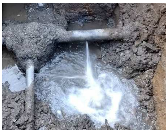
漏水する老朽管
