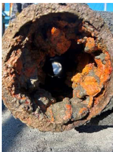
老朽化した水道管の断面
