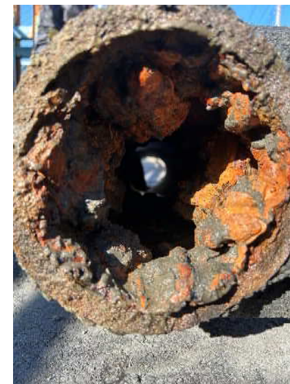
サビによる配管の閉塞
