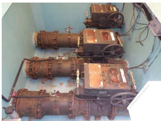
配水池につながる配管 サビによる腐食
