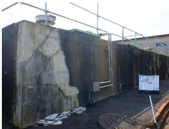
塩素混和池の外壁 経年劣化による外壁の剥離
