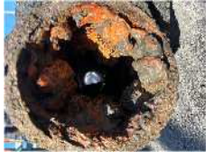
50年以上経過した 配水管の閉塞状況
