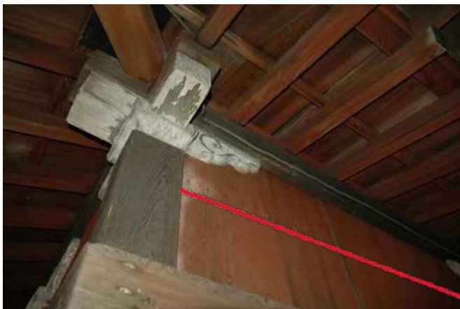
写真4：隅柱の上部、赤線部分の内側に天井がある。
