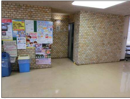
《トイレの入口》 通路幅が不足している（80cm以下）。
