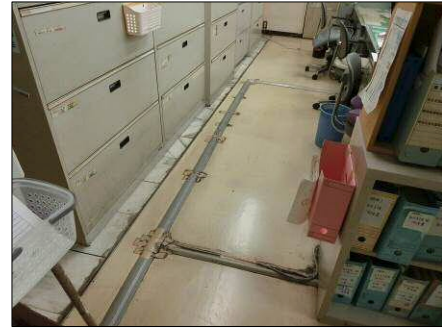
《執務空間④》 電源コードやLANコードを床上に配線している。
